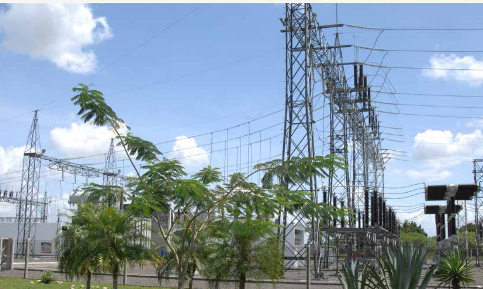
Subestação Santo Antônio de Jesus
