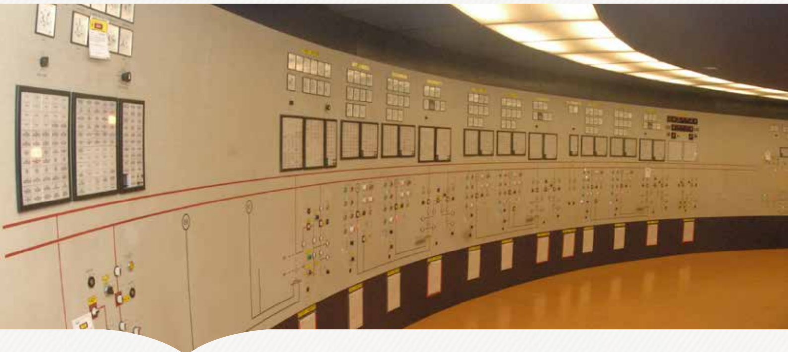
Sala de comando da UHE Luiz Gonzaga
